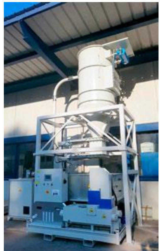
Installation sous vide alimentant une machine à briquettes
