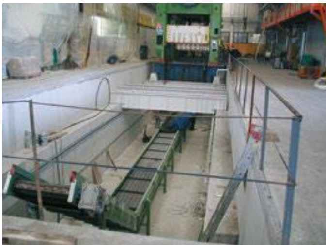
Ligne de transport de copeaux, sous presse
