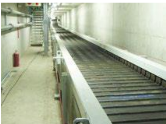
Ligne enterrée pour les chutes de découpe
