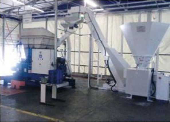
Système de broyage et de briquetage
