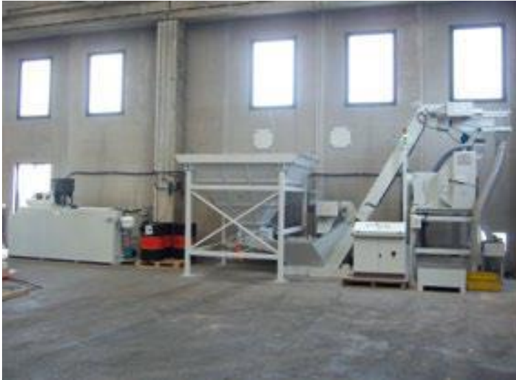
Essorage automatique avec trémie stockage de 6 m3
