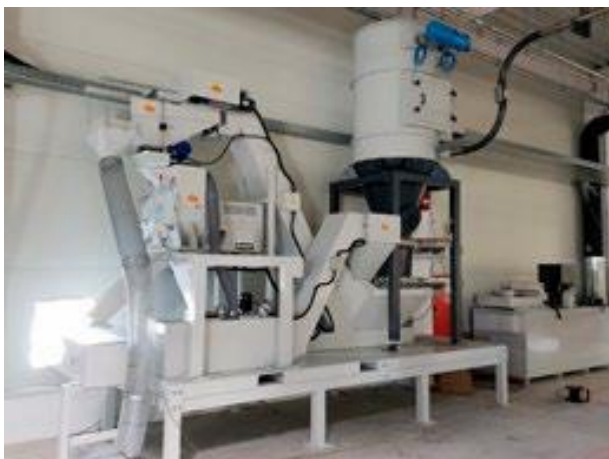
Installation sous vide déchargeant dans un système d'essorage
