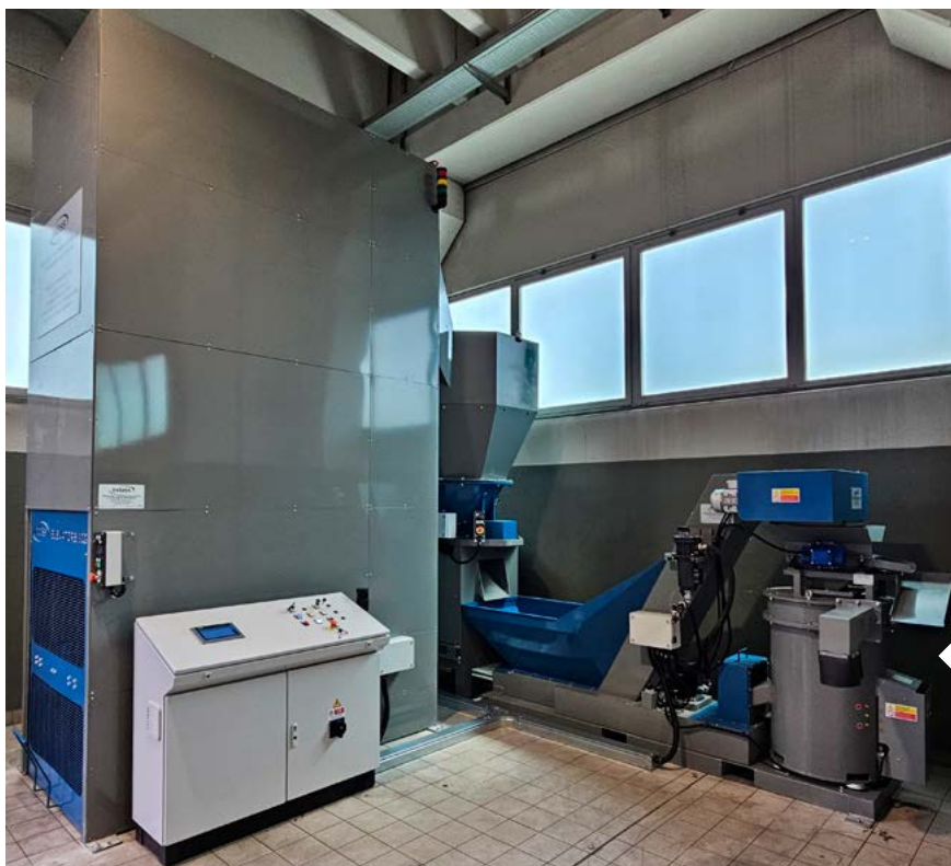
Impianto per l'elevazione automatica dei contenitori, triturazione e centrifugazione trucioli.
