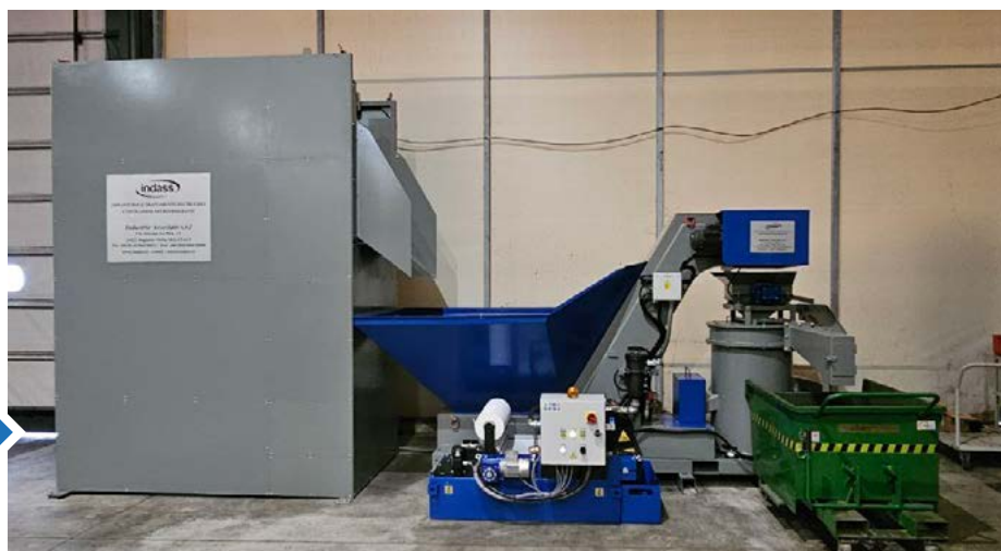
Impianto per l'elevazione automatica dei contenitori, centrifugazione trucioli e filtrazione refrigerante
